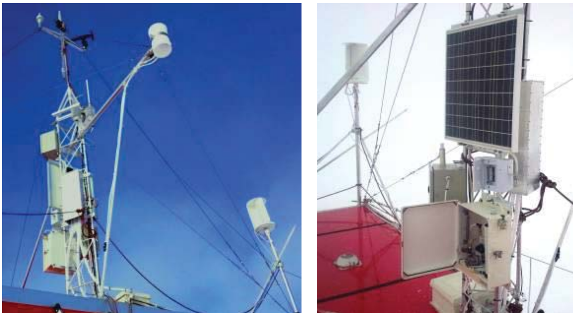
Figura 15 – Vista geral dos sistemas de amostragem instalados no teto do Criosfera 1.
