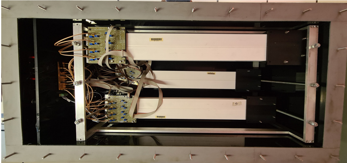
Figura 3.4: Caixa de proteção com estrutura mecânica e placas instaladas.
