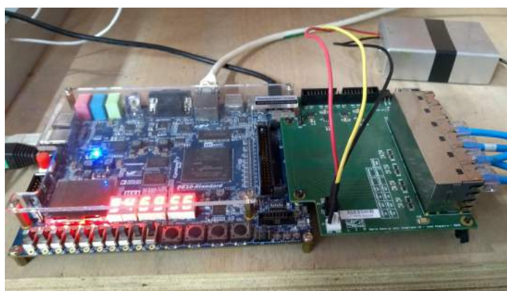
Figura 3.10: CeU com uma Interface conectada, na qual estão conectados cabos UTP.
