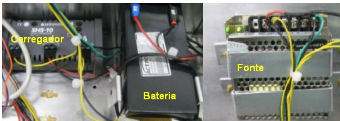
Figura 13 – O carregador de bateria a esquerda, a bateria ao centro e a fonte de alimentação à direita.
