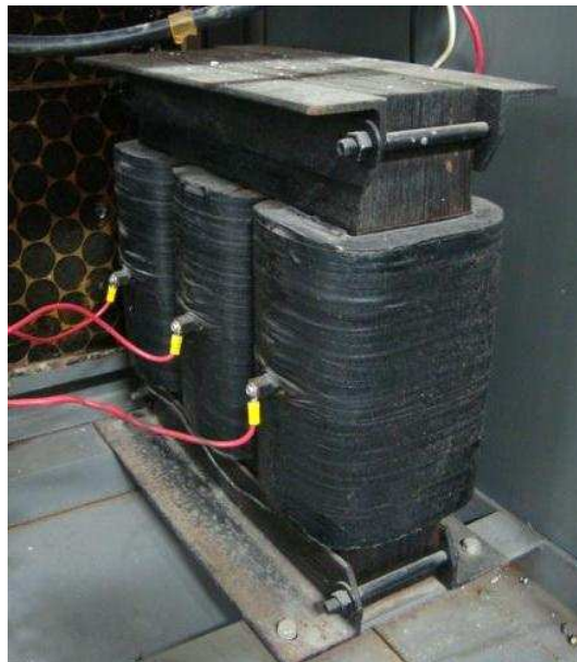
Figura 9.2: Transformador Trifásico de Alta Tensão.
